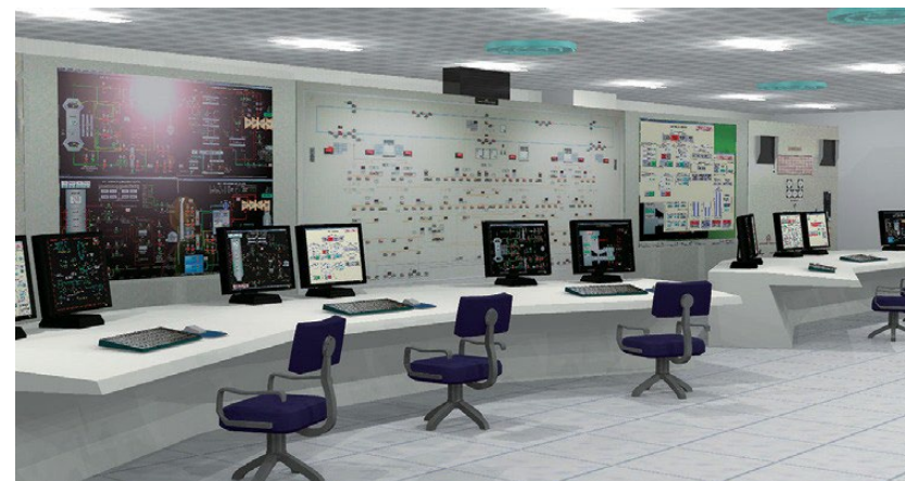
➤ 制御システム
