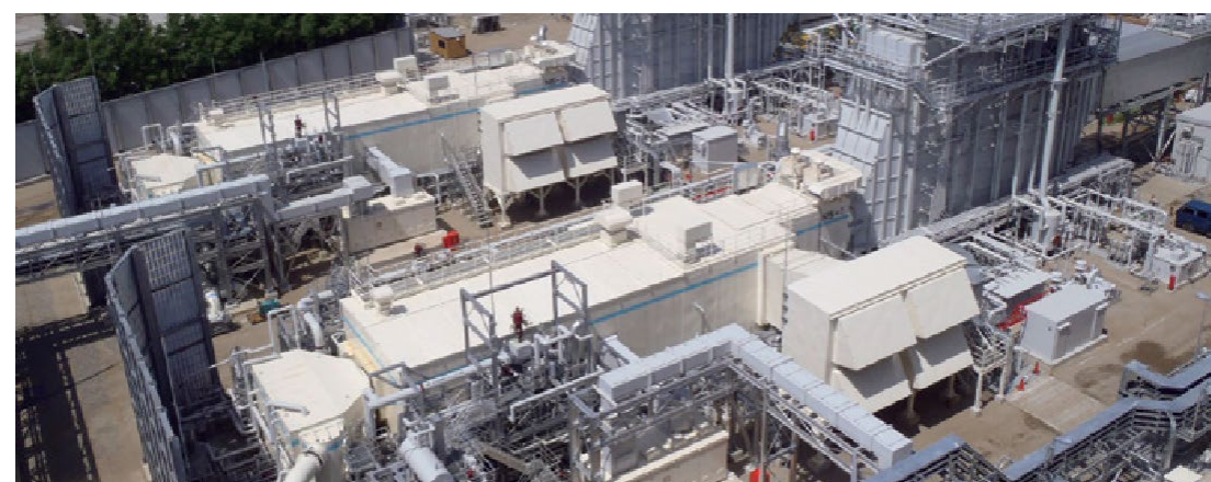
納入先 プラント名(国名) 出力 運転開始年 東北電力株式会社 新潟火力発電所5号系列(日本) 10万9,000kW 2011年
