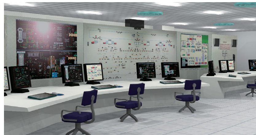
➤ 制御システム
