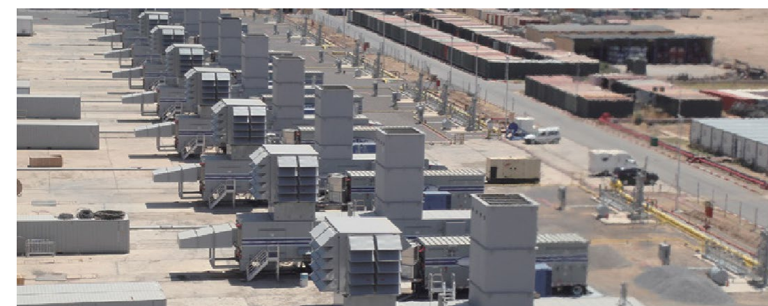
納入先 プラント名(国名) 出力 運転開始年 Sonelgaz社 アルジェリア 1,350MW (FT8MP×54台) 201 年 / 2014年 / 2015年 / 2017年
