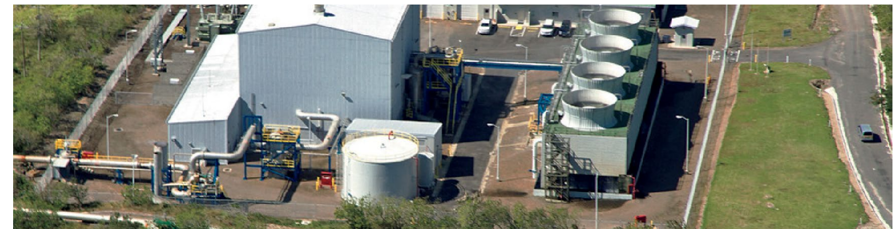
納入先 プラント名(国名) コスタリカ電力公社 ミラバジェスIII発電所 (コスタリカ) 出力 2万7,000kW 運転開始年 2000年
