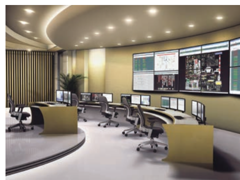
発電所中央制御室 Central Control Room
