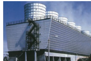
冷却塔 Cooling Tower
