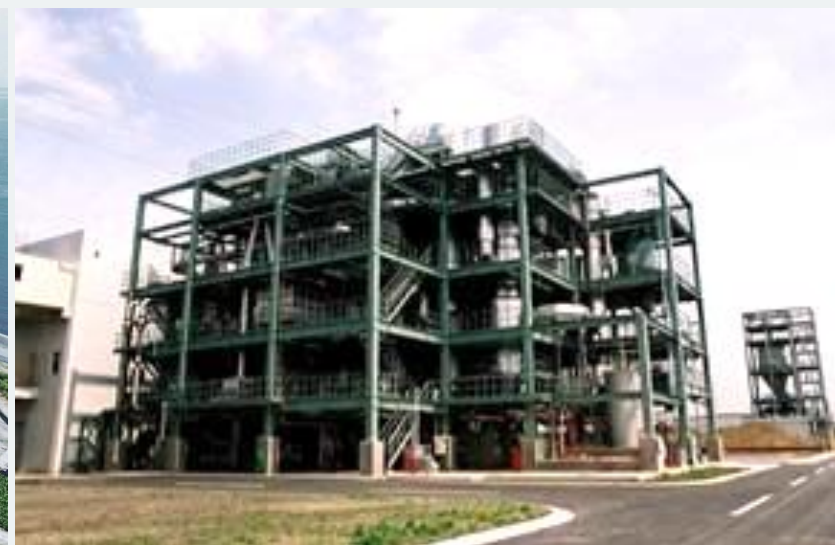
汚泥焼却施設
