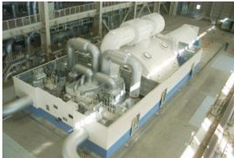
【世界最新鋭2車室型600MW蒸気タービン】
