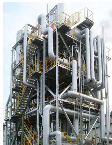
ガスタービン排熱ボイラ Gas turbine HRSG
