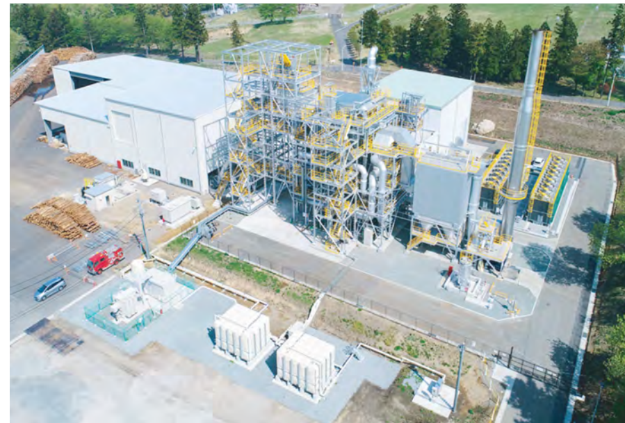
バイオマス発電プラント Biomass fired power generation plant
