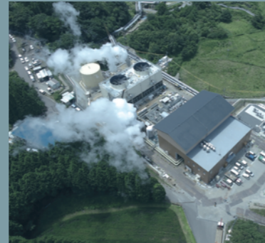
地熱発電設備
