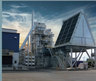
バイオマス発電設備
