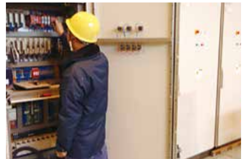
電気制御盤の製品検査
