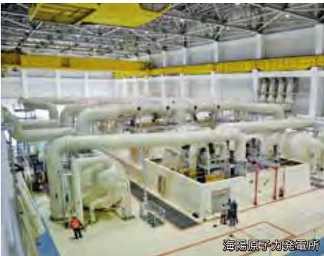
原子力タービン発電設備
