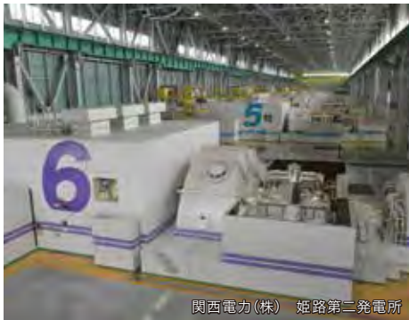
ガスタービン発電設備
