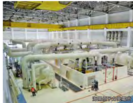
原子力タービン発電設備
