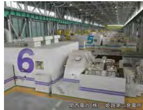
ガスタービン発電設備
