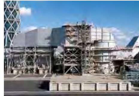
脱硫装置(石炭焚ボイラー(100万kW))用 湿式石灰石・石膏法脱硫装置
