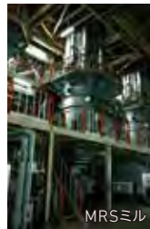
ボイラー用補機
