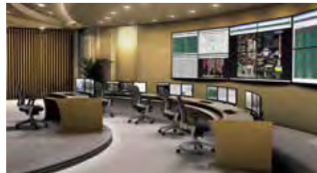
プラント制御システム
