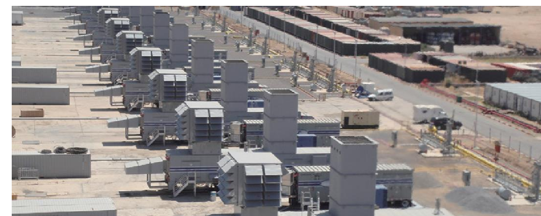
納入先 プラント名(国名) Sonelgaz社 アルジェリア 出力 135万kW (FT8MP×54台) 運転開始年 201年 / 2014年 / 2015年 / 2017年
