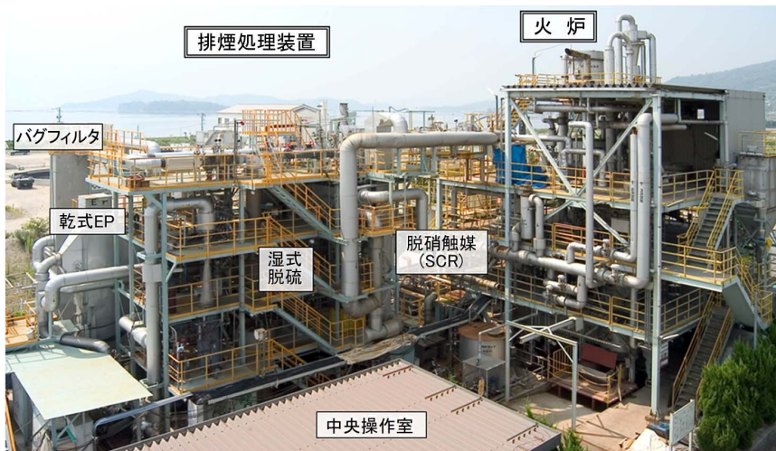
図2 1.5MW 自社パイロット設備の外観
