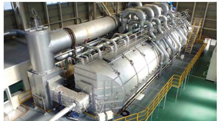
燃焼試験設備(4t/h)
